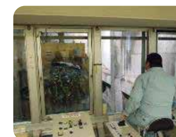
中央制御室の様子
