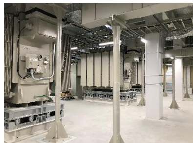
電気設備の地上化
