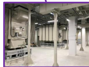
電気設備の地上化
