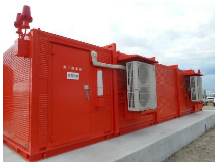
排水ポンプ施設のシェルター化
