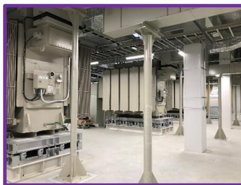
電気設備の地上化
