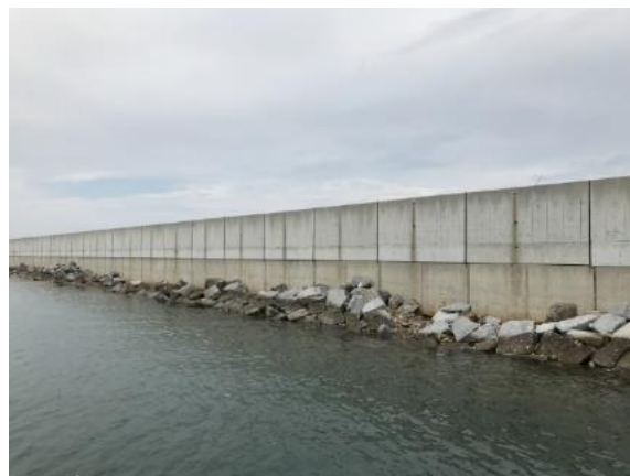
護岸被覆工の破損
