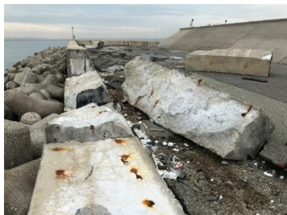
護岸上部工の破損
