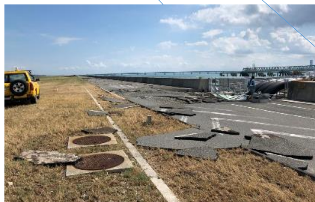
場周道路の剥離
