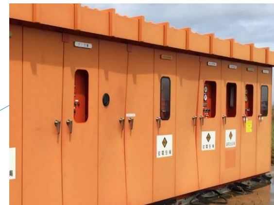
排水ポンプ電気設備への浸水
