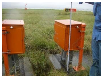
制御盤 （E 1 誘導路周辺）
