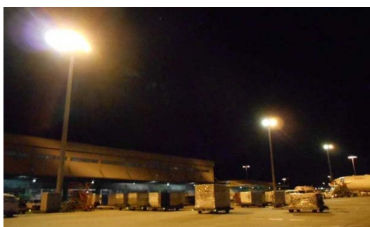
高効率化したエプロンの照明灯
