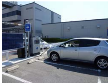
展望ホールの EV 用急速充電器
