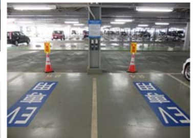
立体駐車場の EV 用普通充電器
