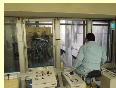
中央制御室の様子
