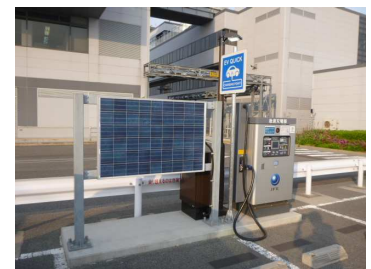
EV用急速充電器
