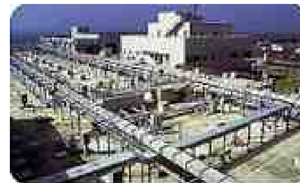
浄化センター
