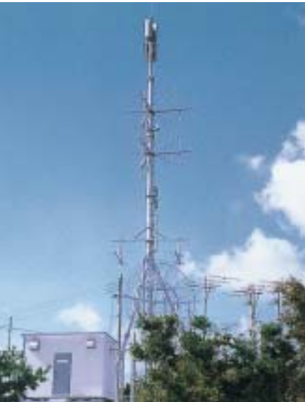
淡路三原SHFテレビ中継放送局 航空機によるテレビ電波受信障害対策としてSHF電波 ※4 を活用した手法は、日本初です。
