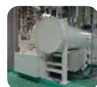
インバーターボ冷凍機
