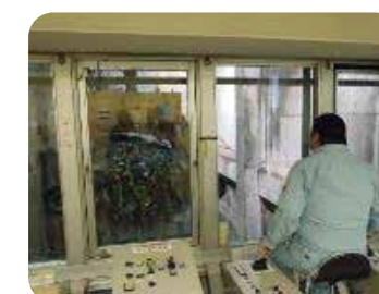
中央制御室の様子
