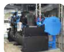
インバーターボ冷凍機
