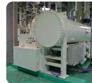
インバーターボ冷凍機
