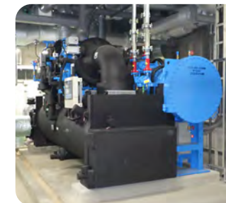
インバーターボ冷凍機
