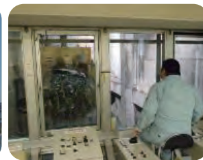
中央制御室の様子
