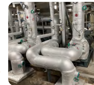
空調用冷温水ポンプ
