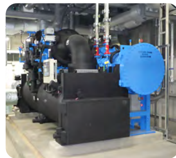
インバーターボ冷凍機
