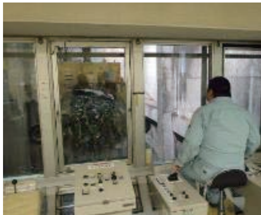
中央制御室の様子
