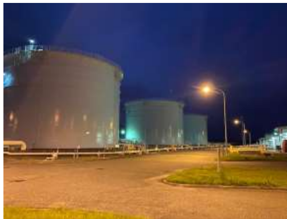
関西国際空港給油センター夜間の様子
