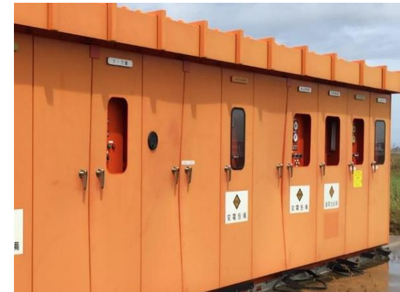
排水ポンプ受配電盤
