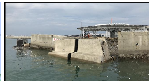
VOR/DME部の護岸転倒箇所からの流入（約7%）
